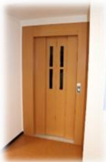
（エレベーター）
